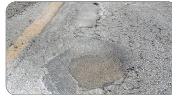
[ 균열 및 포트홀발생 ]
